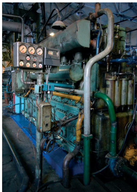
Рисунок 2.24 – машинное отделение дизельной электростанции «ДЭС-16»
