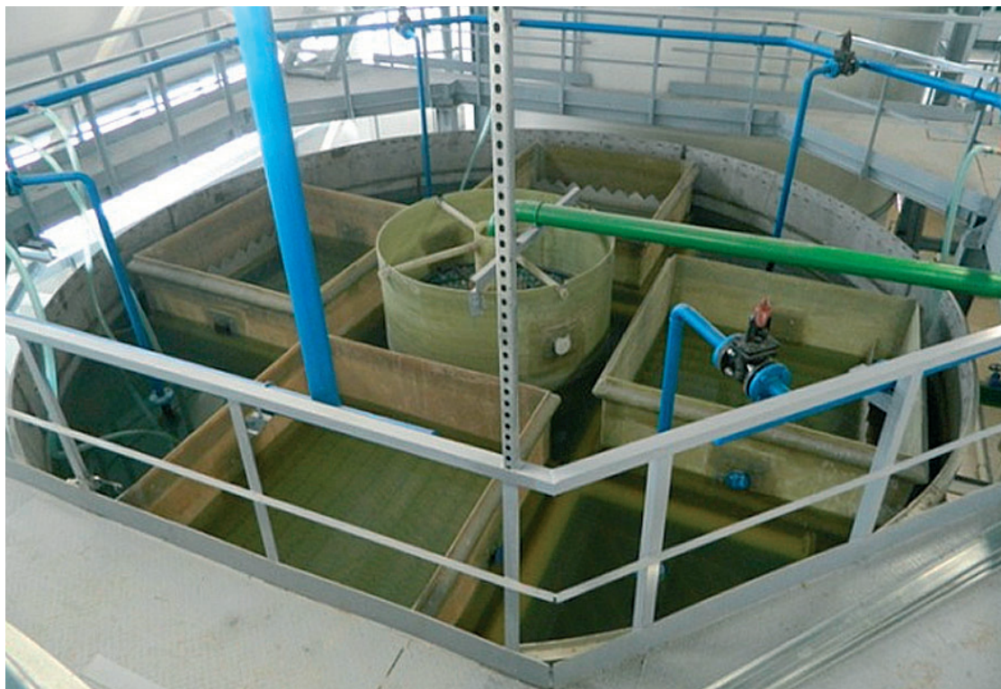
Рисунок 5 - Очистные сооружения серии «БИОТОК М»
